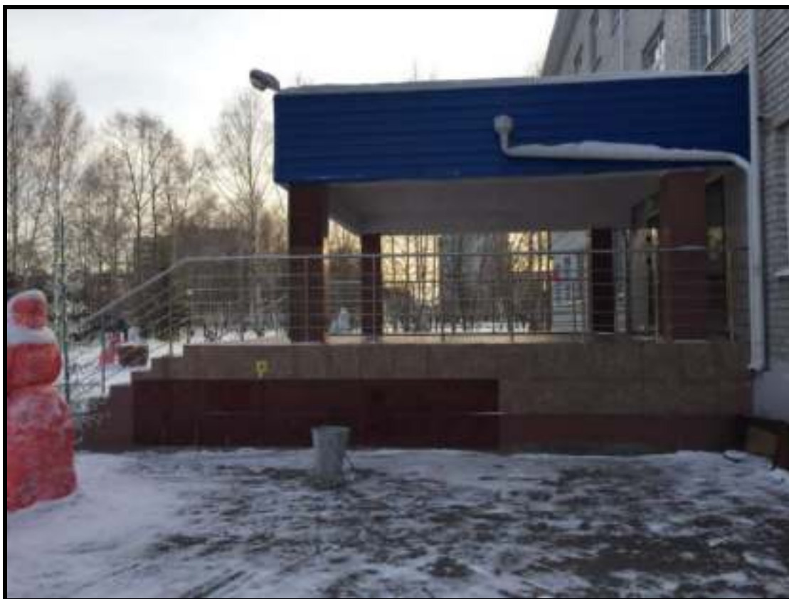
Фото 5 – Парапет с водосточной трубой
